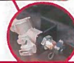
Levegő becsatlakozási pont
